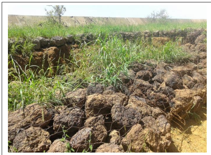
Gabion du bassin de dissipation effondré
